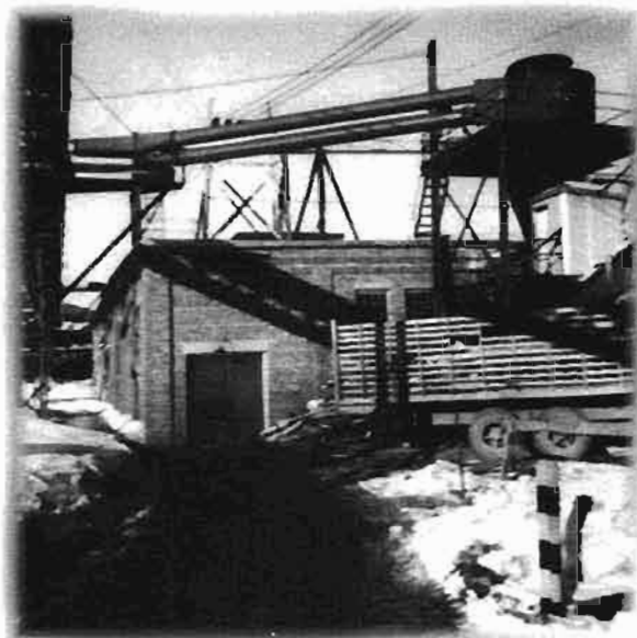
La première «wood room». La démolition était commencée en 1970. Les tuyaux au-dessus étaient tout récents. La porte était l'entrée principale
